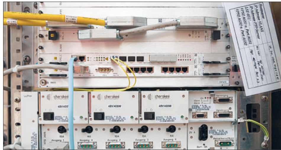
Innenleben eines sogenannten Multifunktionsgehäuses, von hier gehen die schnellen Internetverbindungen in die Haushalte.
